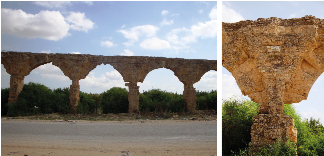
Fig. 3 : État actuel de l'aqueduc après l'arrachement des blocs (Oued Ellil- La Manouba). © M. Adili
