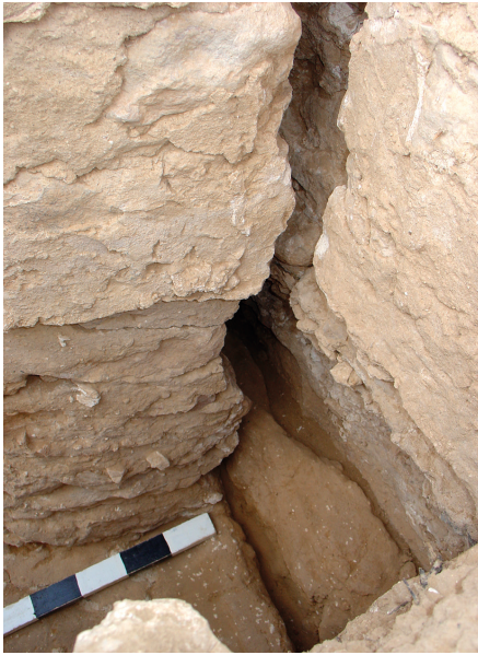
Fig. 9 : Contrefort 102 décollé du mur 101 après enduit commun (cliché J.Thiriot).
